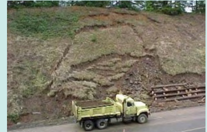
شکل ۳- ناپایداری دیواره خاکبرداری جاده (لویس و همکاران، ۲۰۰۱)
